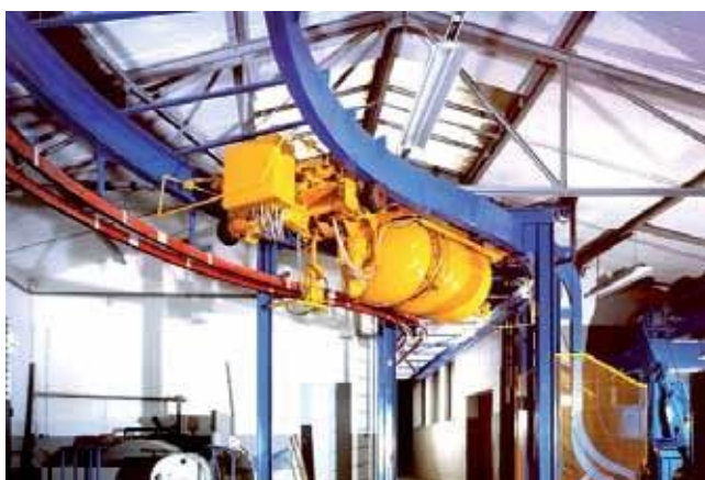
Питание и управление на заводе ж-б конструкций
